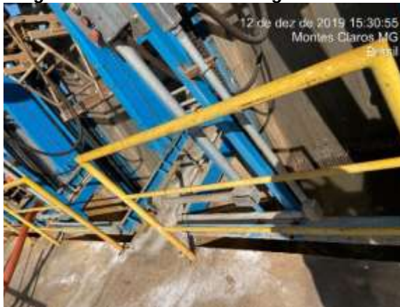
Figura 242 – Gradeamento – grade média.
