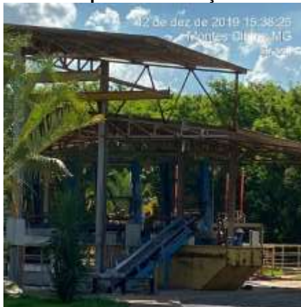
Figura 246 - Resíduos da grade fina sendo dispostos em caçambas.
