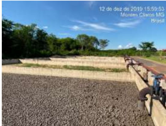
Figura 257 - Leitos de Secagem da ETE Montes Claros.
