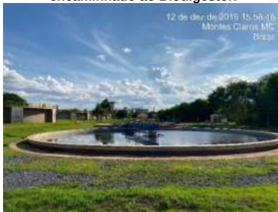
Figura 255 – Decantadores da ETE Montes Claros, onde todo lodo decantado é encaminhado ao Biodigestor.
