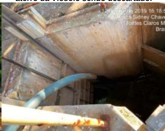
Figura 239 – Chorume que é vindo do aterro da Viosolo sendo descartado.
