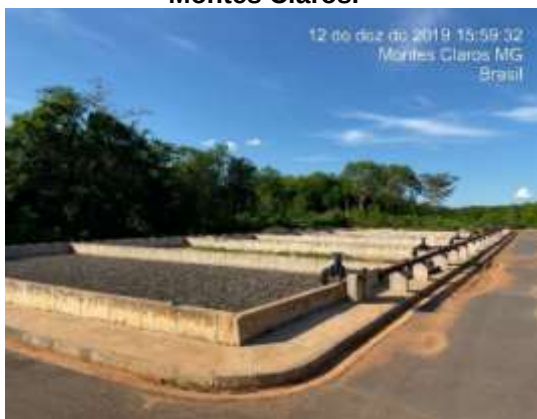
Figura 256 – Leitos de Secagem da ETE Montes Claros.
