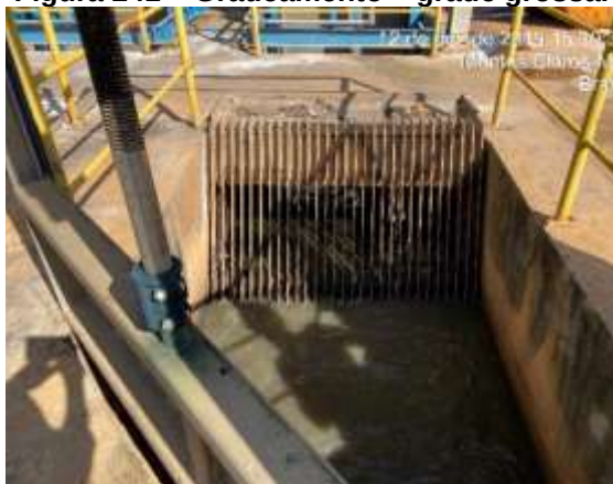
Figura 241 – Gradeamento – grade grossa.
