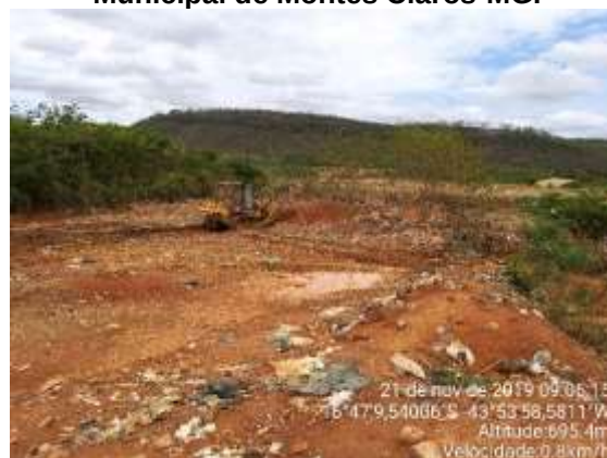
Figura 178 - Situação atual do Aterro Municipal de Montes Claros-MG.
