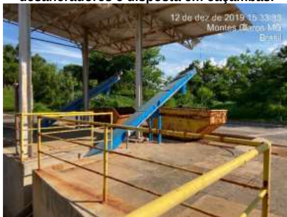
Figura 247 – Areia sendo retirada dos desaneradores e disposta em caçambas.
