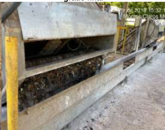
Figura 245 – Resíduos sendo retirados da grade fina.
