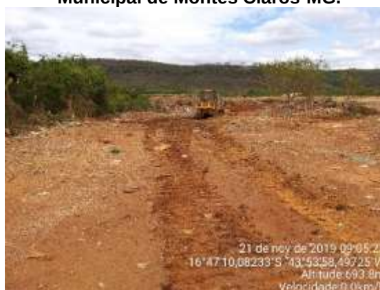
Figura 176 - Situação atual do Aterro Municipal de Montes Claros-MG.
