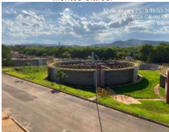
Figura 254 – Filtros Biológicos da ETE Montes Claros.
