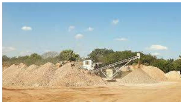
Figura 96 – Usina de Reciclagem RCC.
